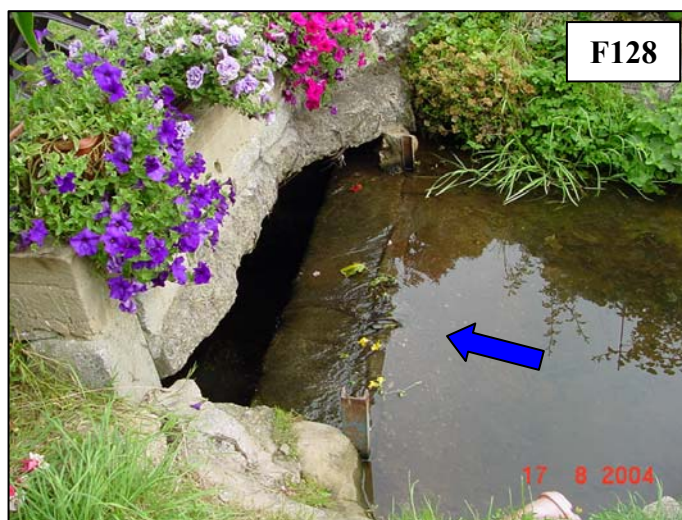
Zatrubnění toku u Surových. Zatrubnění je v délce cca 200 metrů, při vyšších průtocích voda přetéká a vybřežuje.
